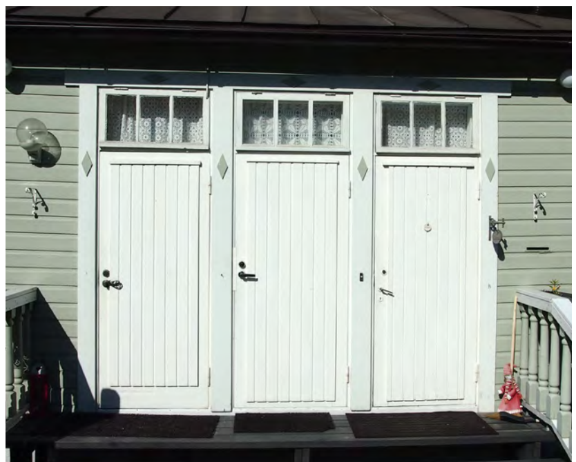
Kuistille johtaa kolme 1950-luvun oven tyyppistä ulko-ovea. Ovet johtavat kolmeen erilliseen asuntoon. Ovien yläpuolella on ikkunat. Valkoinen on alueelle uusi oviväri.
