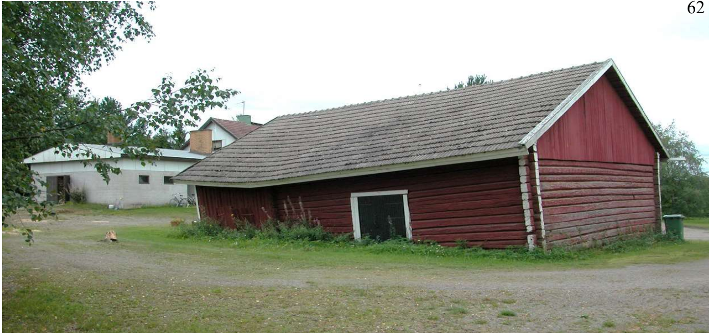
Kuva 62: Vanhan ulkorakennuksen voisi vielä pelastaa nostamalla hirsikehikon irti maasta. Kuva kylien rakentamistapaohje.
